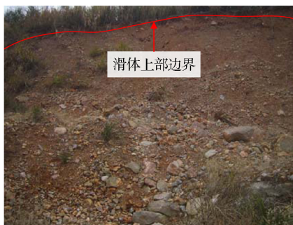
图9 山东北排土场典型滑坡
